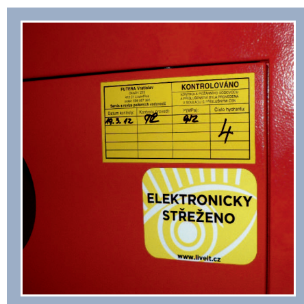
Štítek s informací o elektronickém zabezpečení
